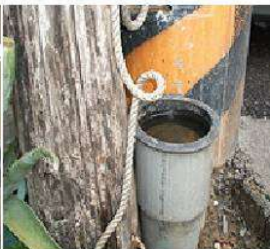
台電地下電纜引上管
