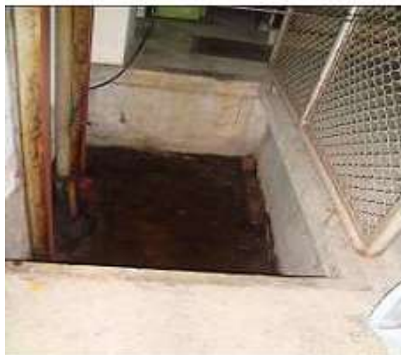
地下室之升降梯孔積水
