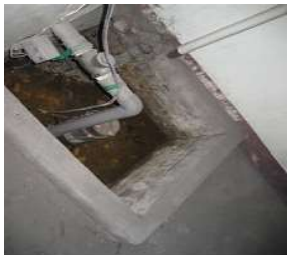
地下室儲水槽
