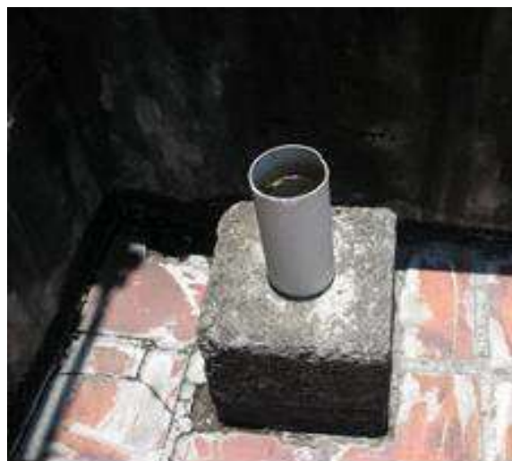
水泥樁上之水管
