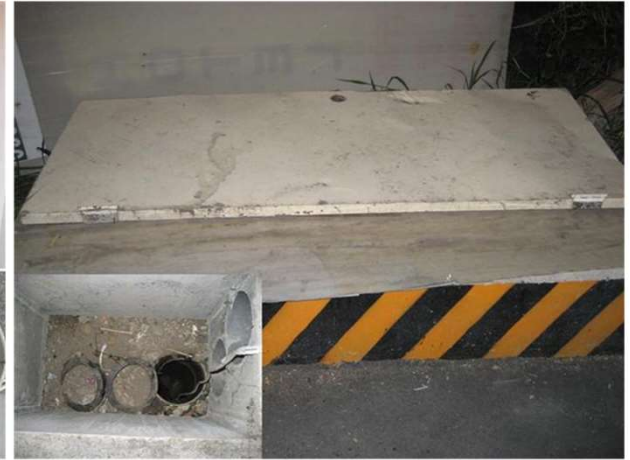
電信電纜管道
