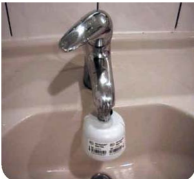
圖一 於病房水龍頭末端出水口安裝頗爾過濾器 (0.2 μm)
