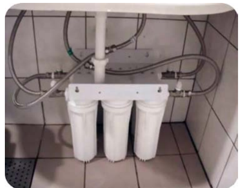
圖二 於病房水龍頭出水口前 60 公分處安裝自組三道過濾器 (5 μm、1 μm 及 0.2 μm)
