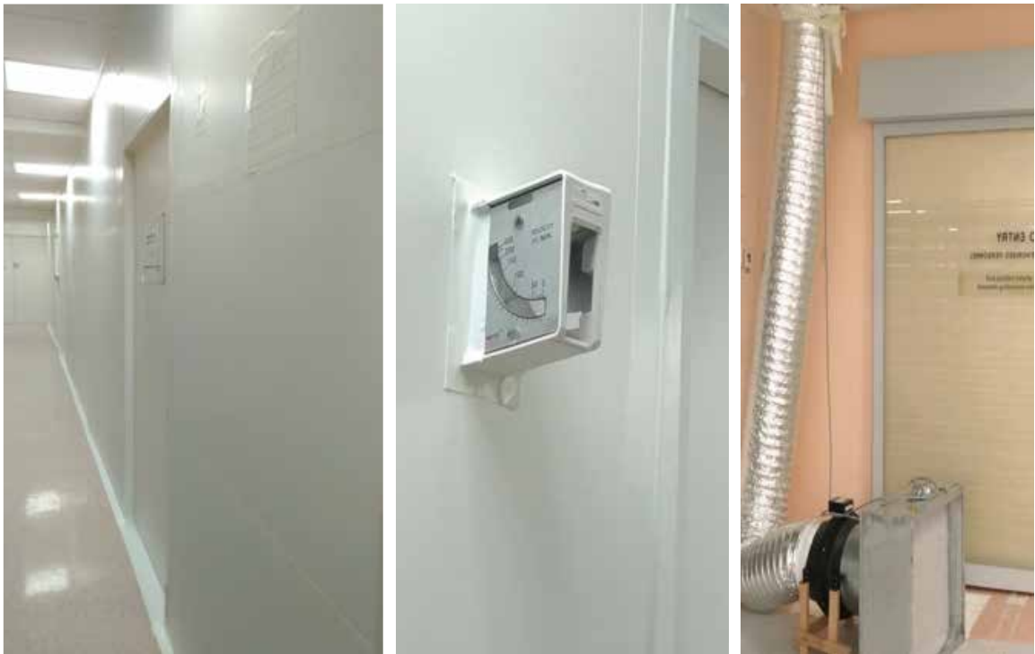
圖五 施工區圍籬防護落實，各接縫處再以強力膠布封黏，於施工門外牆上設有負壓顯示器，內部設有加強排風設備
