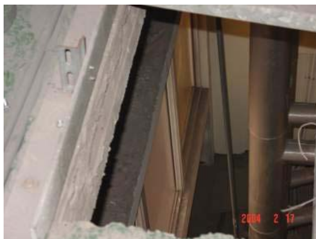
圖一、生物安全櫃及實驗室排氣系統共管(管道間共管處相片)
