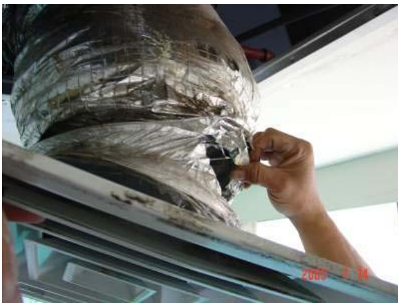
圖四、軟管破損相片
