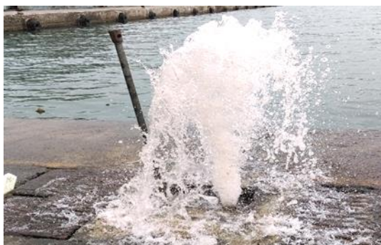
(D) 12 號碼頭港岸供水點於水壓正常下之水柱高度。
