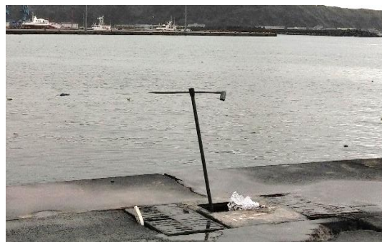
(B) 12 號碼頭港岸供水點於水壓異常下之水柱高度。
