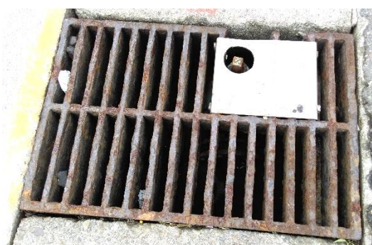
(C) 8 號碼頭之港區配水管制水閥。
