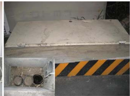
電信電纜管道
