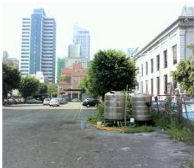
停車廠水塔無蓋
