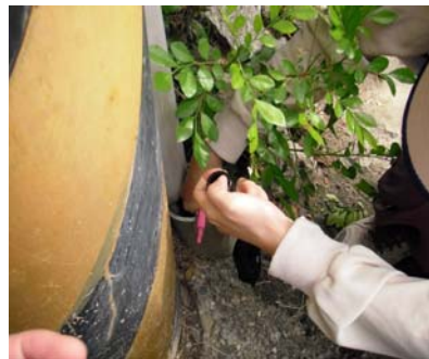
地下電纜引上管
