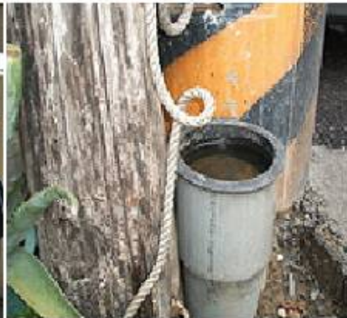
台電地下電纜引上管
