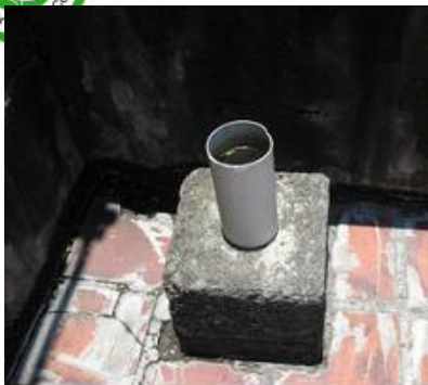
水泥槽上之水管
