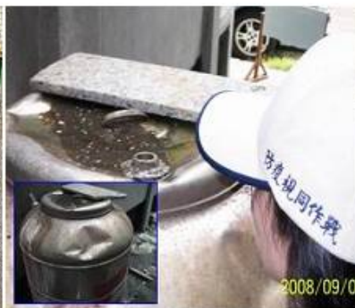
儲水桶鐵蓋凹陷處
