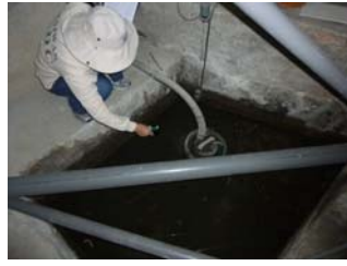
南區府南里地下停車場蓄水槽發現孳生大量病媒蚊子
