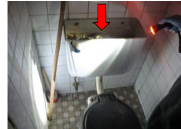
中西區藥王里空屋廁所，馬桶水箱無蓋，孳生病媒蚊子
