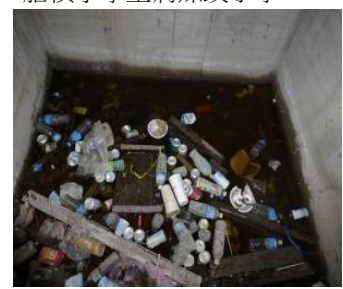
東區大同里工地電梯間積水，孳生大量病媒蚊子子 81
