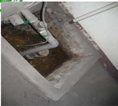
地下室儲水槽
