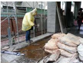
北區中樓里工地地面積水孳生病媒蚊子子
