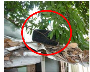
北區大和里鐵皮屋屋頂2輪 胎積水孳生病媒蚊子子
