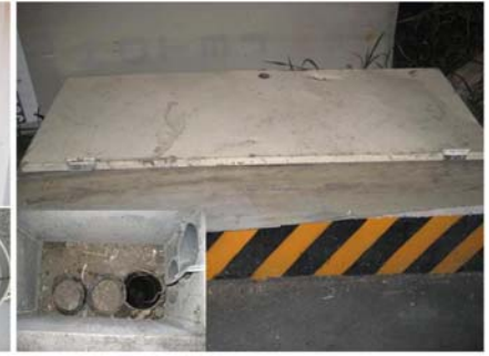
電信電纜管道
