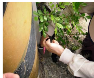
地下電纜引上管
