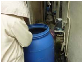
南區大忠里防火巷水桶發現孳生大量病媒蚊子
