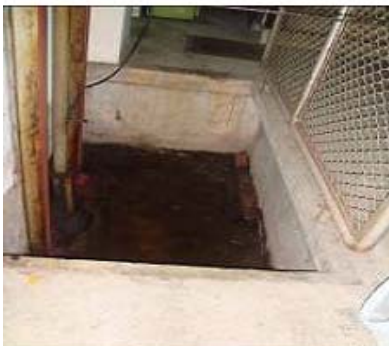
地下室之升降梯孔積水
