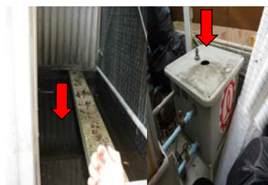
北區和順里大型冷卻水塔及過濾水箱，孳生病媒蚊子
