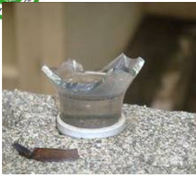
防竊盜圍牆碎玻璃
