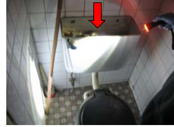
中西區藥王里家內廁所久無人使用，馬桶水箱無蓋，積水並孳生病媒蚊子子
