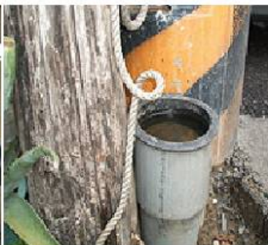
台電地下電纜引上管
