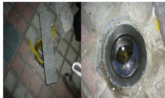
安南區海佃里連棟別墅地下室停車場用石塊及塑膠桶蓋住，水泥圓洞積水，孳生病媒蚊子孑孓
