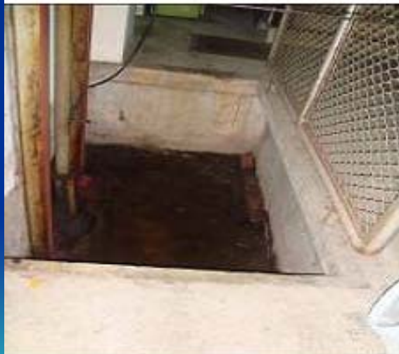
地下室之升降梯孔積水
