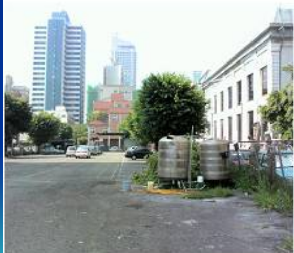
停車廠水塔無蓋
