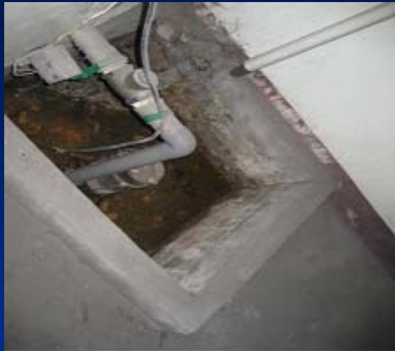
地下室儲水槽
