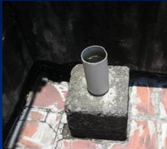
水泥樁上之水管
