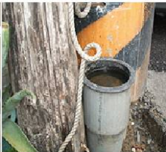
台電地下電纜引上管
