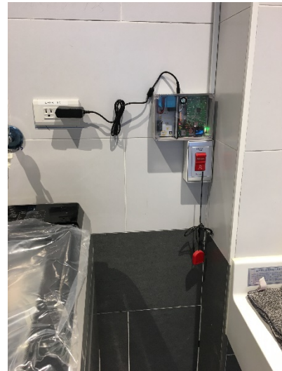
圖 56. 民生醫院附設護理之家清潔消毒室
