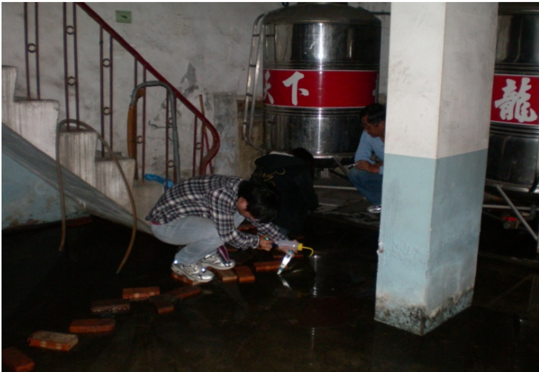
圖 7. 第三型積水地下室：水質清澈乾淨的大面積輕度積水。 上圖為新興區順昌里中 O 街 60 號~62 號地下室；下圖為苓雅區五福里 大順三路 000 巷 24~30 號。
